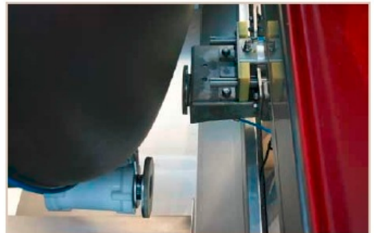
Konektory na bubnu a konstrukci lisu - přerušené propojení
